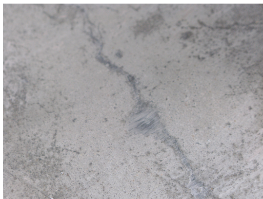
DETALLE DE GRIETA TOMADA CON SELLAGRIET®
