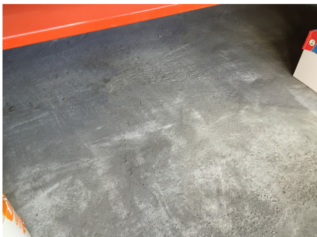
PISO MUY POROSO CON DESPRENDIMIENTO DE POLVO
