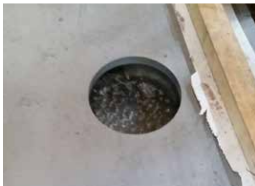
DETALLE SOPORTE ESCARIFICADO Y HÚMEDO
