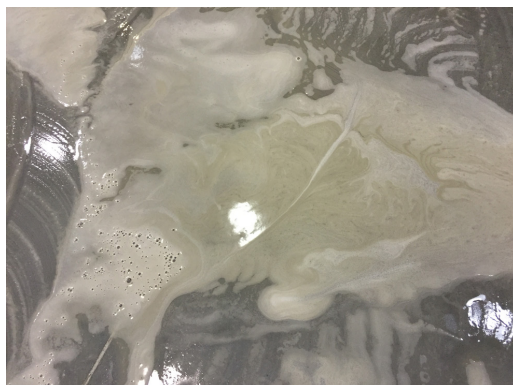
DEGRADACIÓN DEL FILM DE CURADOR O CERA
