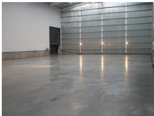
PISO DE HORMIGÓN SIN JUNTAS
