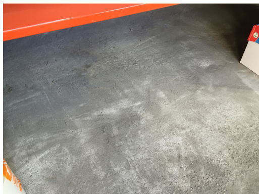
PISO MUY POROSO CON DESPRENDIMIENTO DE POLVO
