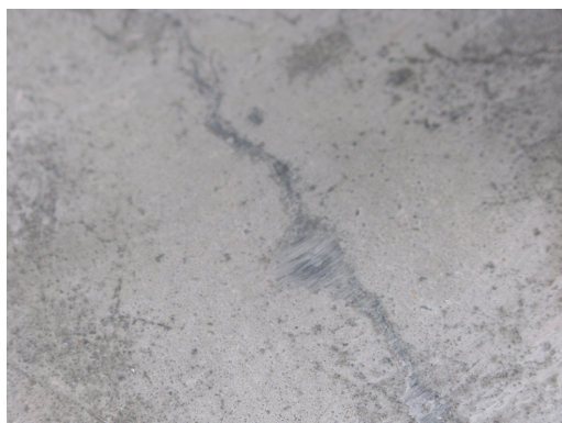
DETALLE DE GRIETA TOMADA CON SELLAGRIET®
