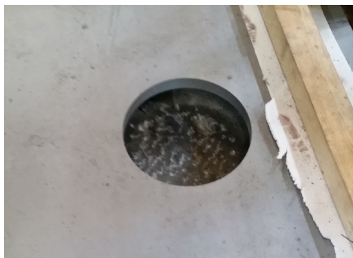
DETALLE SOPORTE ESCARIFICADO Y HÚMEDO
