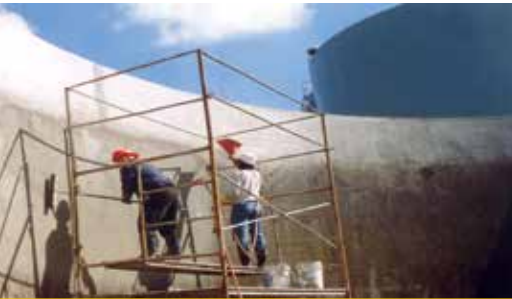
Planta de Tratamiento de Aguas Residuales Annacis Island, Vancouver, British Columbia, Canadá.
