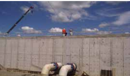
Planta de Tratamiento de Agua Batu Kitang, Batu Kitang, Kuching, Malasia
