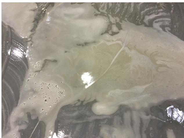
DEGRADACIÓN DEL FILM DE CURADOR O CERA
